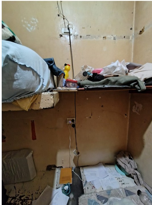
Instalaciones eléctricas precarias
