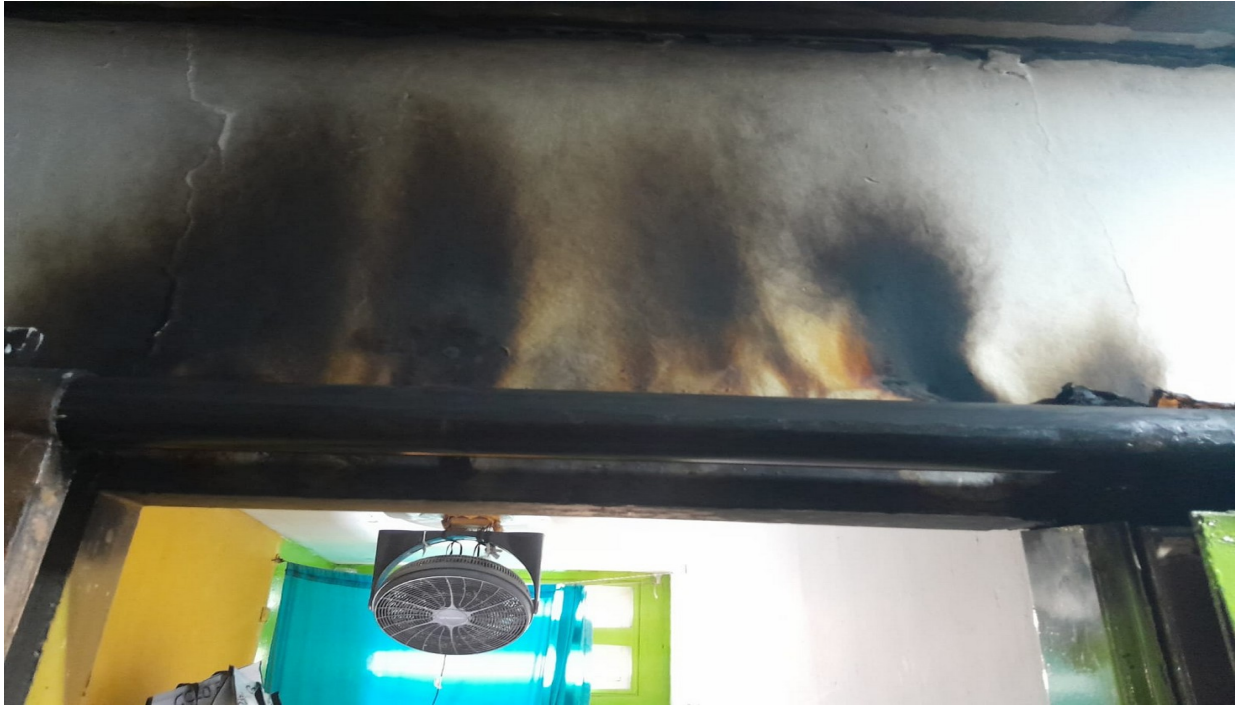
Pabellón 4. Paredes quemadas
