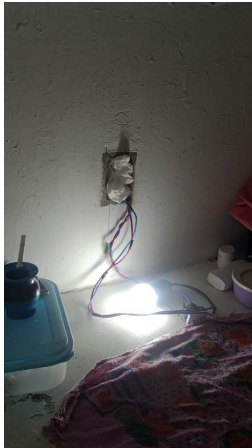
Pabellón 4. Instalación eléctrica precaria
