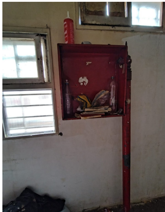
Falta de manguera contra incendios
