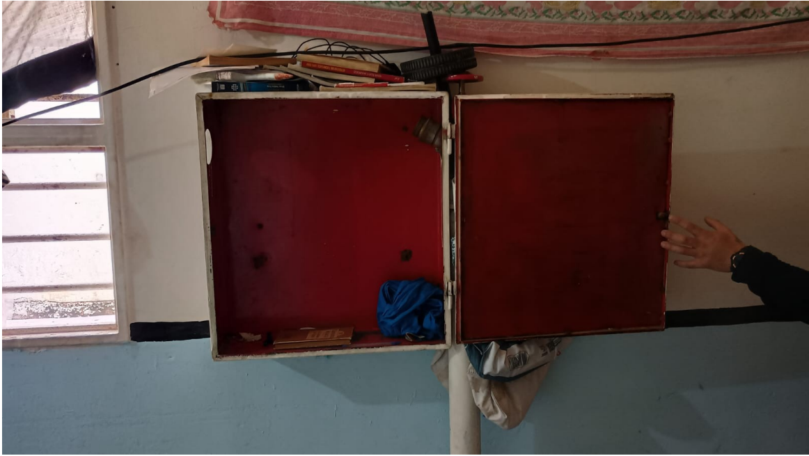
Falta de manguera contra incendios
