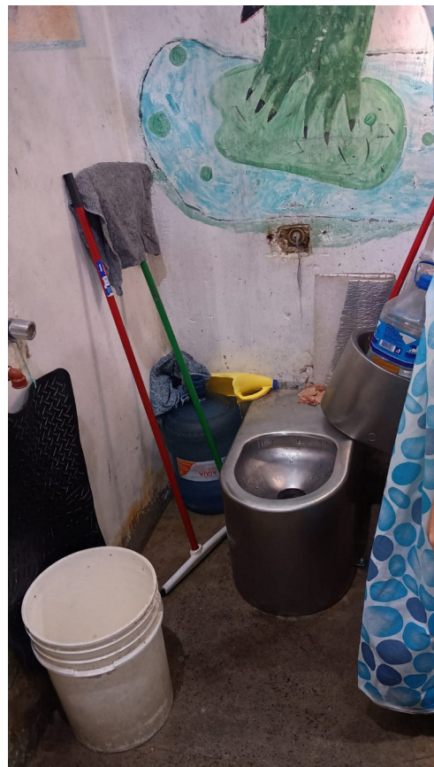
Único baño habilitado, en celda 3
