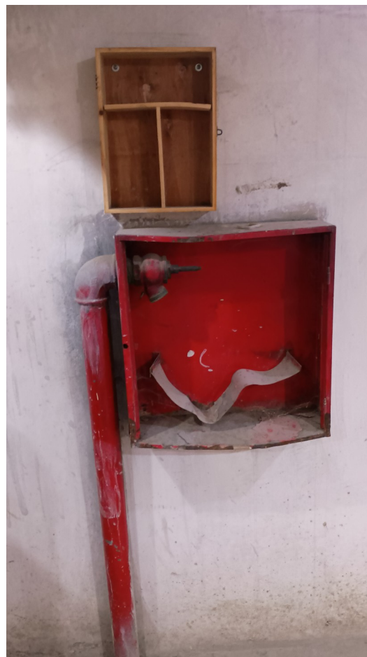
Gabinete para manguera contra incendio, vacío
