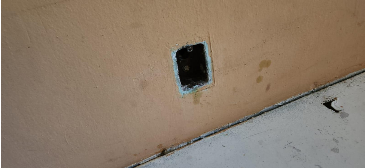
Ausencia total de cableado en el Pabellón 6B
