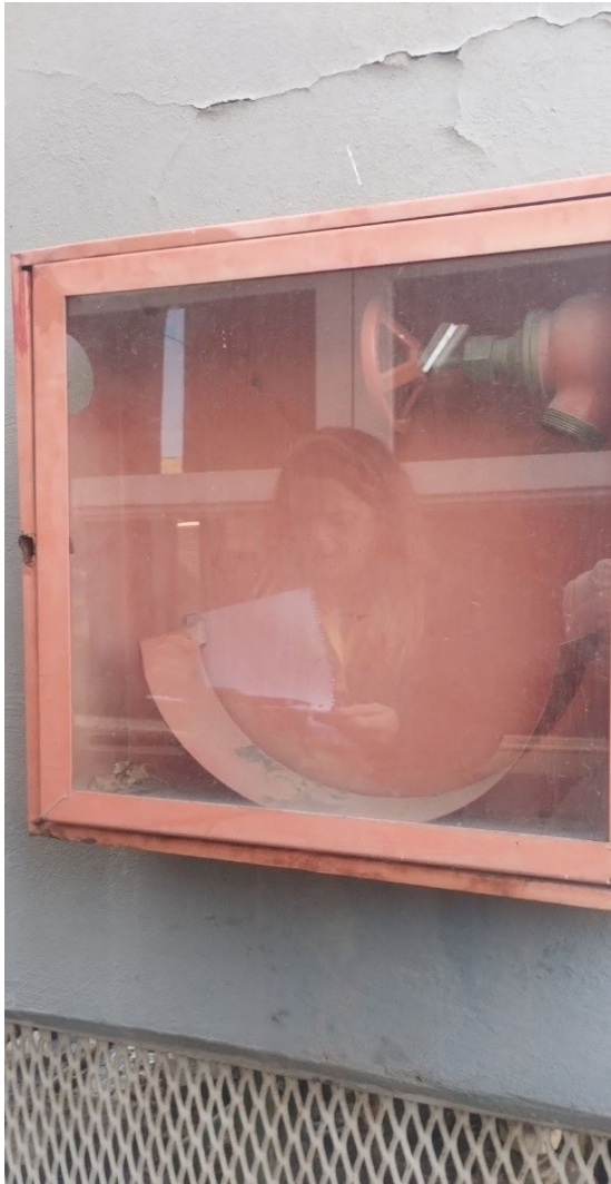
Comisaría 3°. Gabinete contra incendio con faltante de manguera
