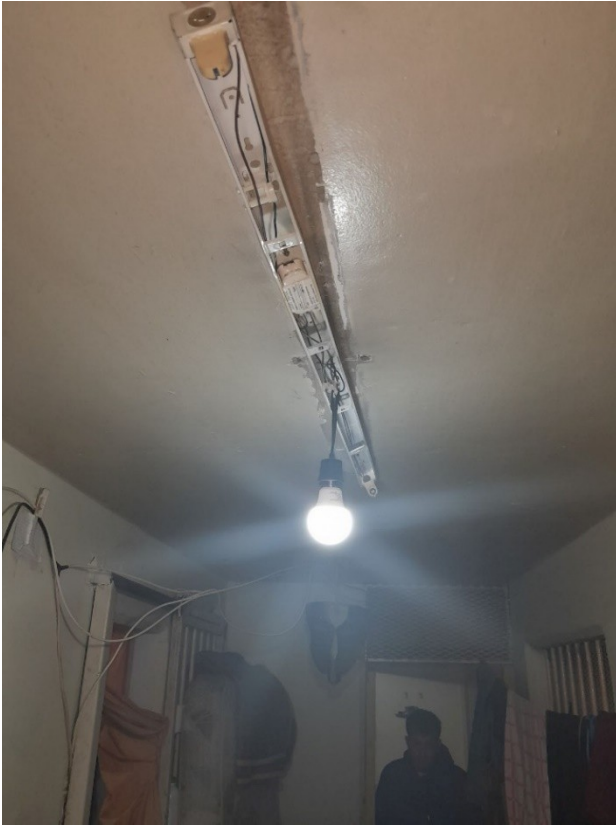
Comisaría 18. Instalación eléctrica precaria
