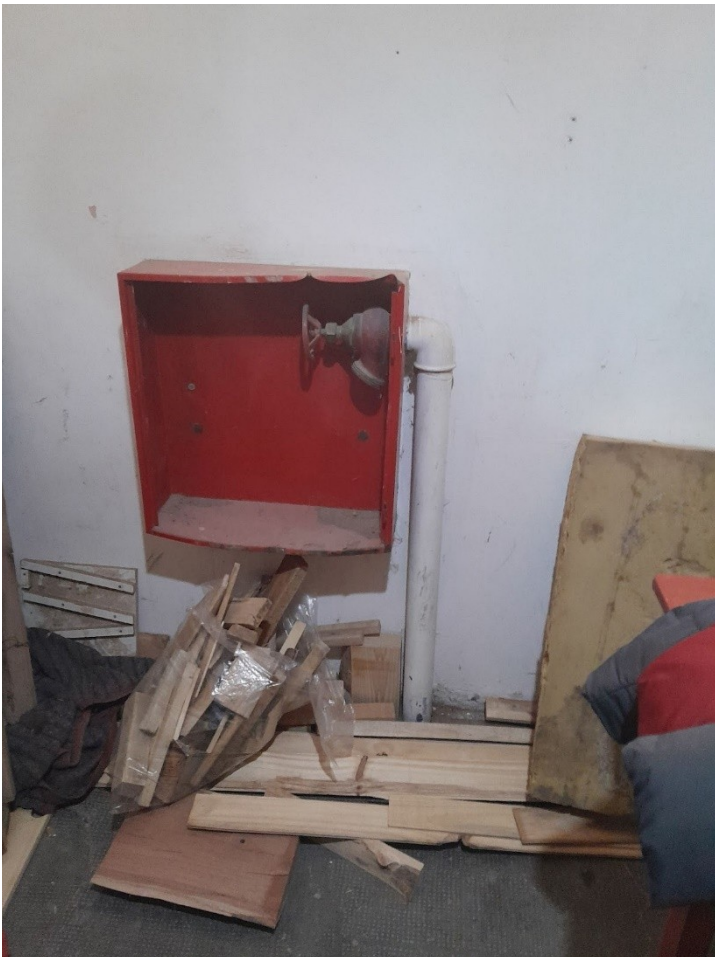
Comisaría 18. Gabinete contra incendio con faltante de manguera
