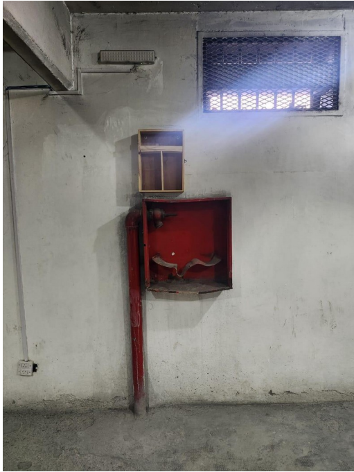
Comisaría 46. Gabinete contra incendio con faltante de manguera
