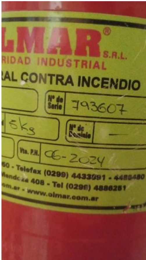
Comisaría 1: Imagen del único matafuego que se encontraba en el pasillo de ingreso al sector de las celdas el cual estaba vencido el 6/24.
