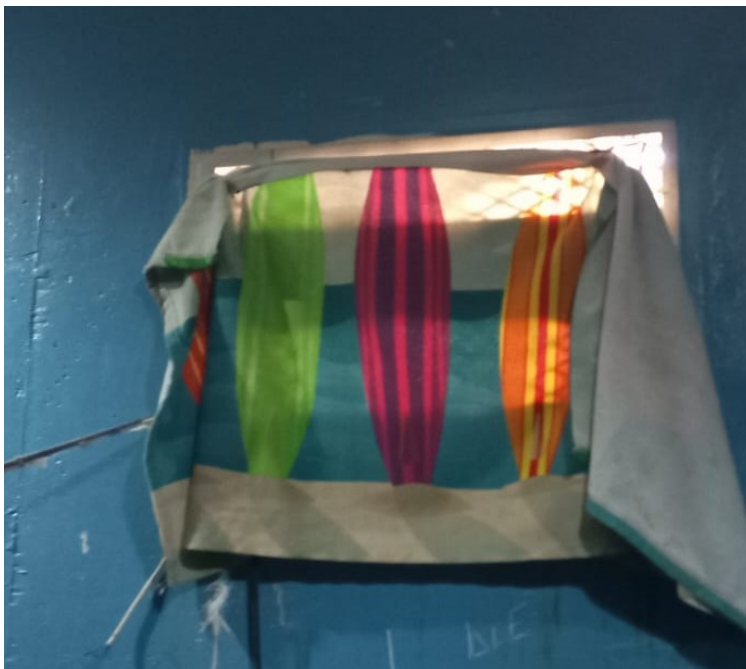
Comisaría 17 Ventana de la celda tapada.
