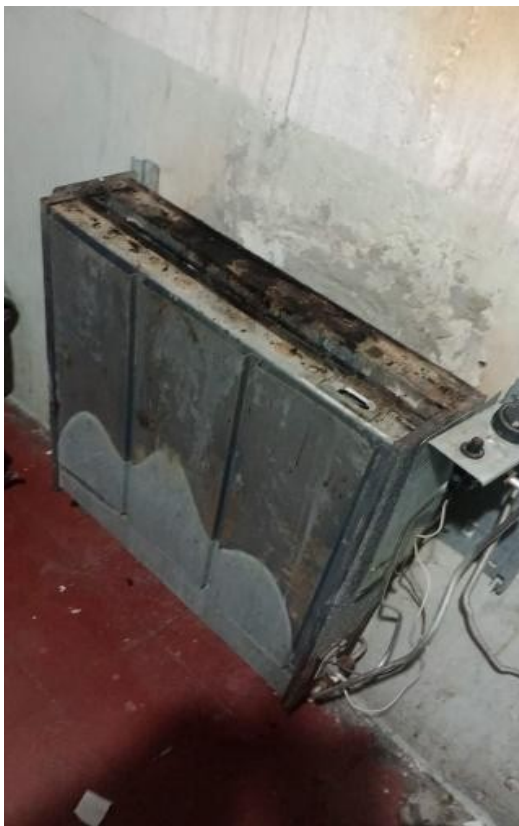
Comisaría 5. Calefactor en mal estado
