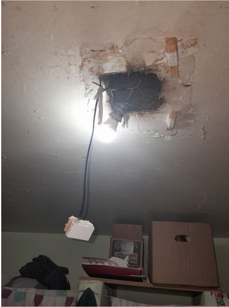
Comisaría 18. Instalación eléctrica precaria
