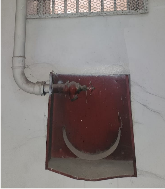
Comisaría 12. Gabinete contra incendio con faltante de manguera
