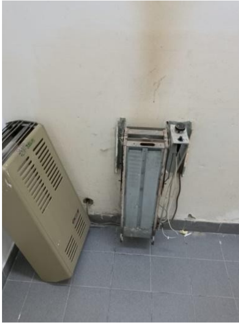
Comisaría 41. Calefactor en mal estado.
