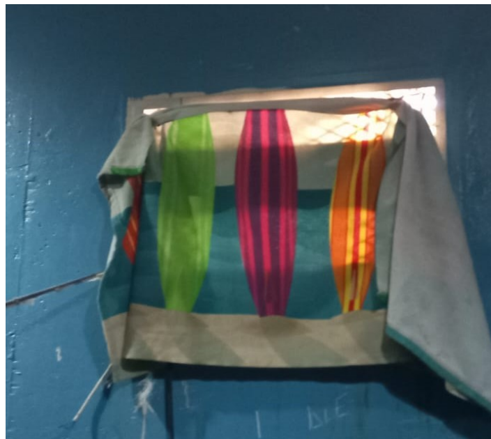
Comisaría 17 Ventana de la celda tapada.
