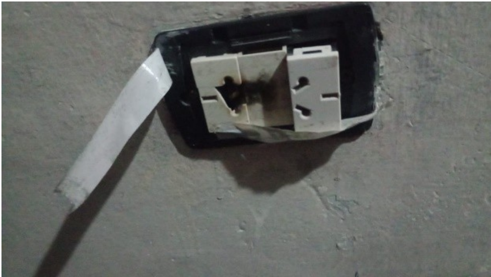
Comisaría 3. Conexiones eléctricas precarias
