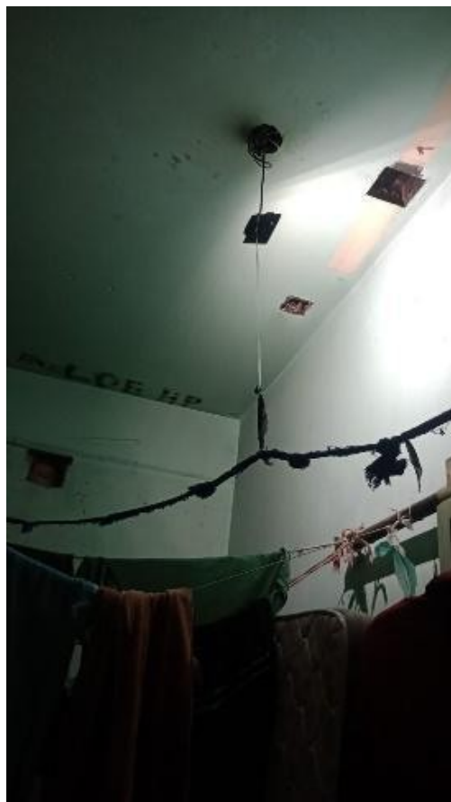
Comisaría 1. Imagen del único artefacto de luz y de la instalación eléctrica precaria
