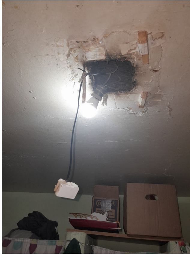
Comisaría 18. Instalación eléctrica precaria
