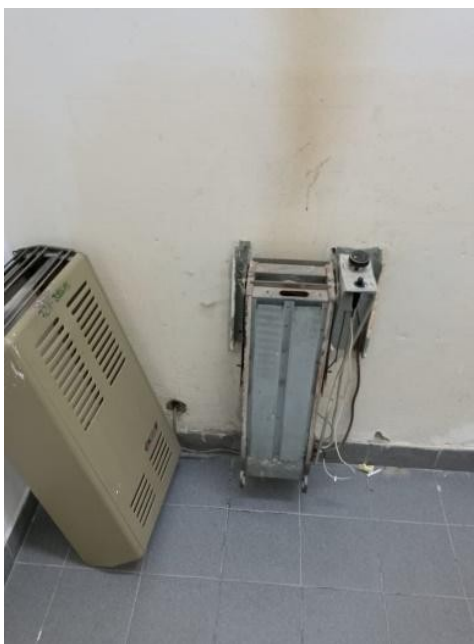
Comisaría 41. Calefactor en mal estado.
