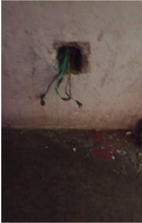
Comisaría 5. Imagen de cables eléctricos colgando a 30 cm del piso
