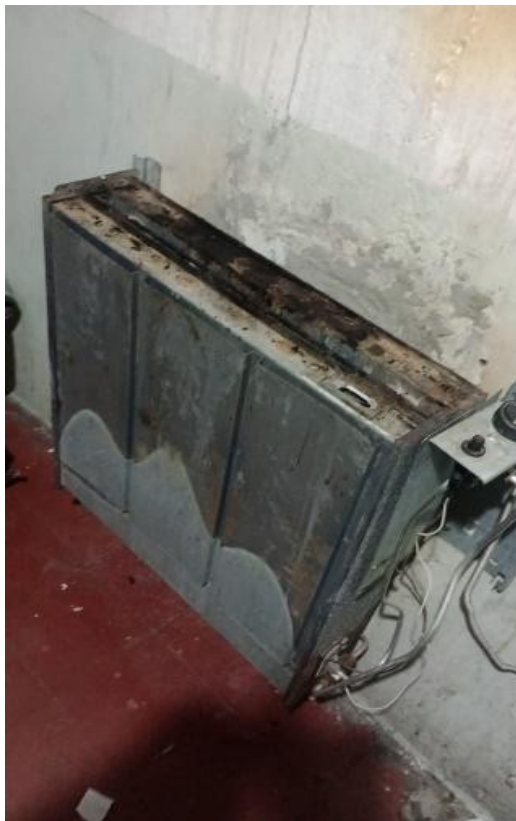
Comisaría 5. Calefactor en mal estado
