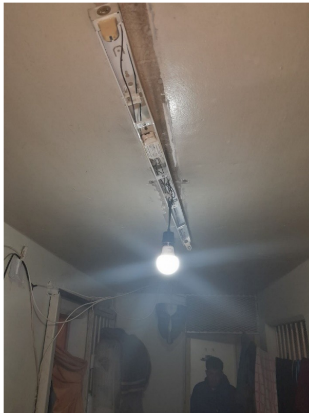
Comisaría 18. Instalación eléctrica precaria
