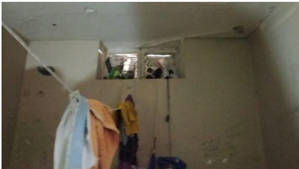
Comisaría 5. Ventana tapada. Falta de luz natural
